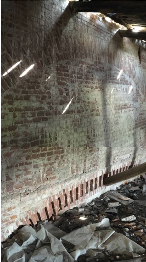
Fig. 7 - Archi di scarico nel muro trasversale alla base della torre nel sottotetto.
