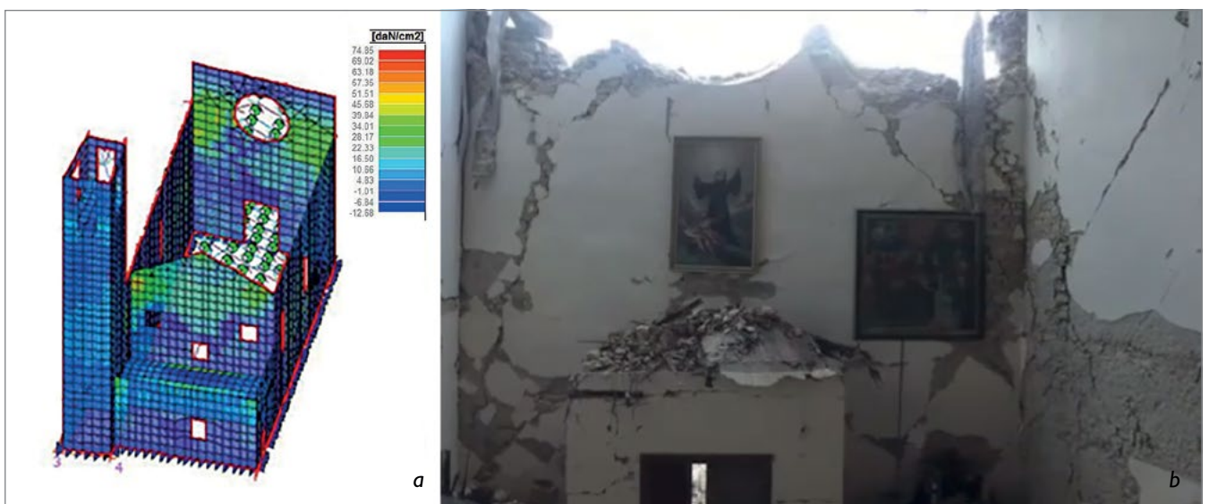
Figura 24. (a) Mappa delle tensioni principali nelle strutture murarie della chiesa di Sant'Agostino dopo scossa sismica del 24 agosto 2016; (b) stato di danno reale nella facciata vista dall'interno chiesa.
