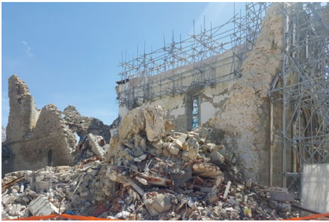
Figura 1. Situazione del crollo della chiesa di Sant'Agostino ad Amatrice prima della rimozione delle macerie (29 luglio 2017).
