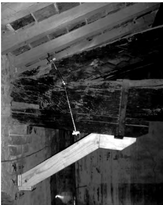
Figura 13. Sostegno di nodo di capriata, la cui catena è gravemente danneggiata e deformata, con contraffisso ligneo (Tampone con la collaborazione di P. Derinaldis, Certaldo, 2009).
