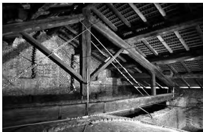
Figura 5. Ex Chiesa di S. Carpofo, Milano: consolidamento degli appoggi e delle capriate mediante cavi esterni post tesati, con inserimento di un nuovo puntello ligneo di contrasto della falda.
