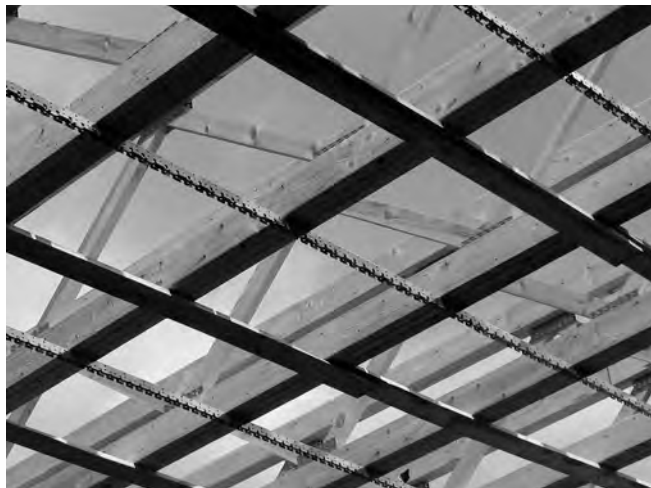
Figure 7. La copertura dei due blocchi dedicati ad aule, laboratori e dormitori prima della posa in opera dell'isolamento e delle lastre copertura e controsoffitto.
