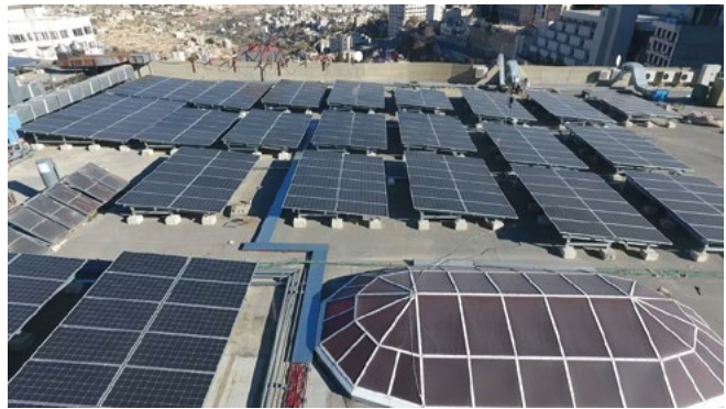
Figura 1. Impianto fotovoltaico sul tetto della Bus Station.
