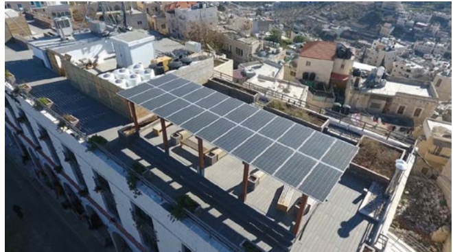
Figura 2. Impianto fotovoltaico sul tetto dell'Engineering Department.
