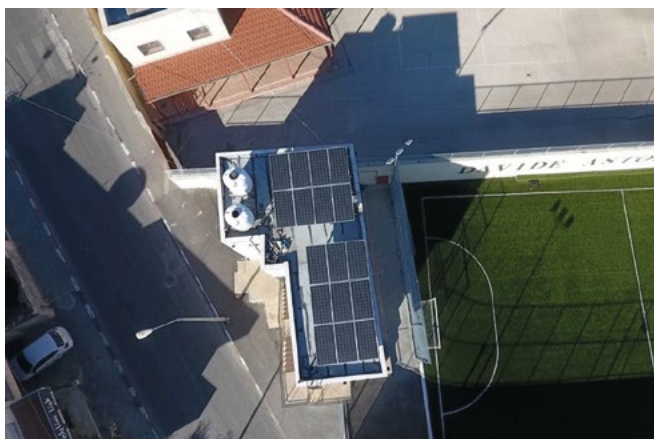
Figura 3. Micro-impianto sugli spogliatoi del campo sportivo Davide Astori.
