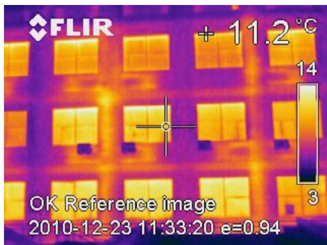
Figura 2. Immagine termografica di una facciata del Politecnico prima degli interventi di sostituzione dei serramenti e dei radiatori, e di isolamento dei sottofinestra. Si osservino anche le unità esterne dei condizionatori individuali, ora sostituiti da un impianto centralizzato condensato ad acqua di falda.
