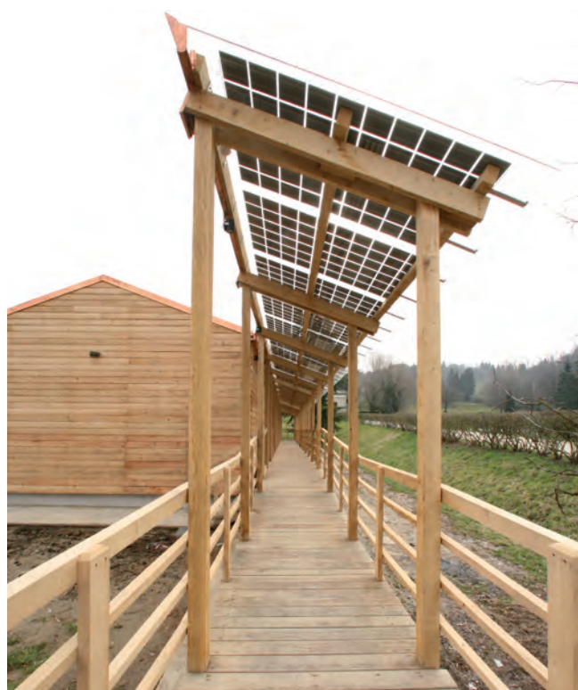
Figura 9. Il portico fotovoltaico di ingresso.
