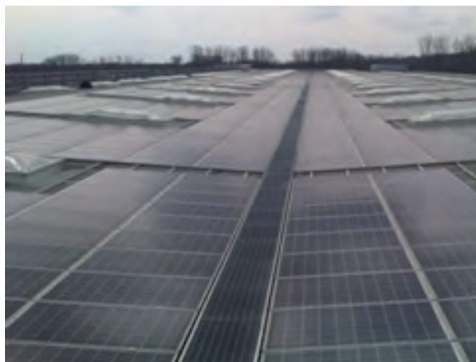
Figura 3. Stabilimento produttivo di Gattinara (VC): vista dell'impianto fotovoltaico installato in copertura.
